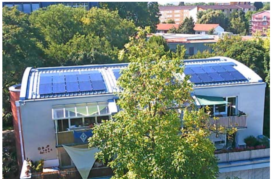
Diese Photovoltaikanlage auf dem Dach versorgt die Kita Melanchthonweg mit Strom.
